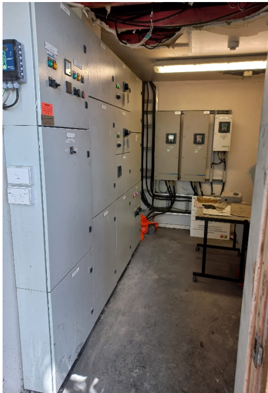
Ngaruawahia switch room
